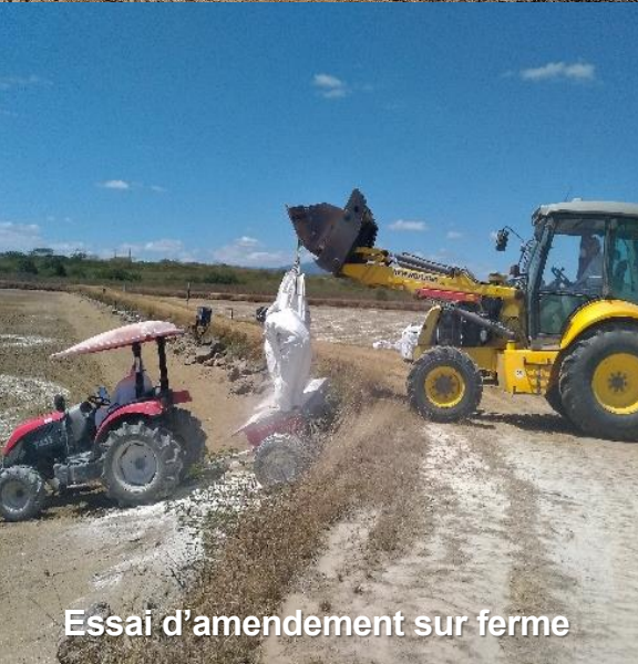
Bassin de production
